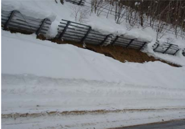
写真 6.2 柵最下段に発生したクラック (R453号 盤尻)
