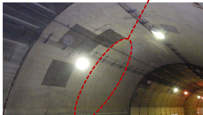
写真 5.12 ひび割れ状況
