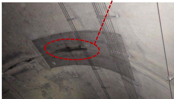
写真 5.11 浮き・ひび割れ状況
