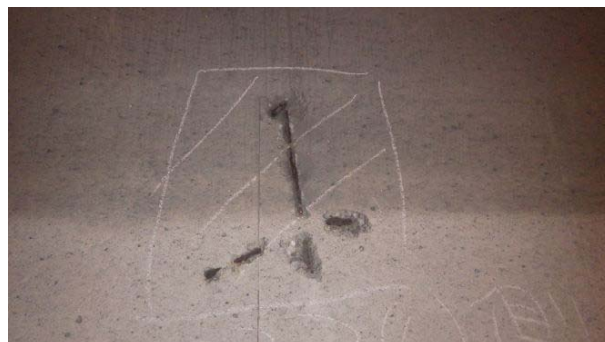
写真 5.3 鉄筋被り部の剥離状況
