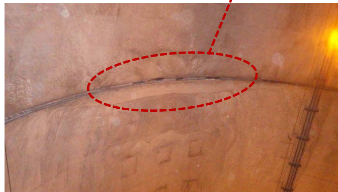
写真 5.13 浮き・ひび割れ状況
