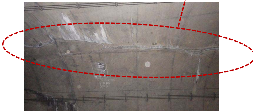
写真 5.9 ひび割れ状況
