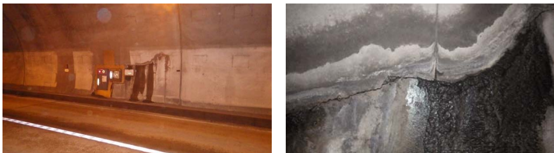
写真 5.1 漏水状況（左：全景、右：拡大）
