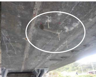
遊離石灰（未補修部）
