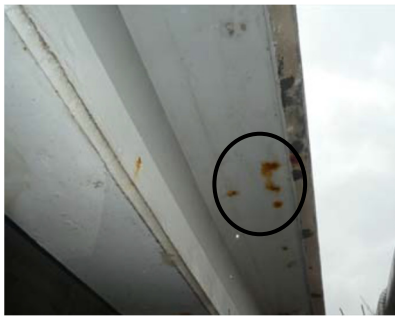
上ワング補修部の錆汁
