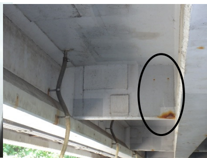
横桁補修部の錆汁
