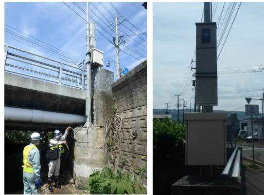
通電設備（電線、分電盤）
