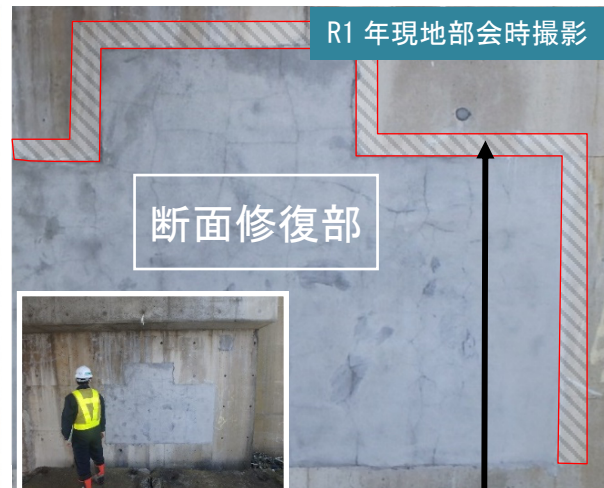
下部工：断面修復箇所「近傍」 のうき⇒マクロセル腐食
