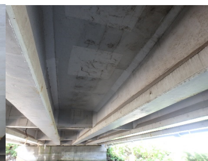
床版下面補修部のうき
