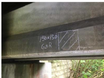
補修部のうき
