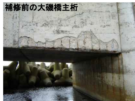
写真 4.2 山側の塩害損傷事例 （補修前の大磯橋主桁）
