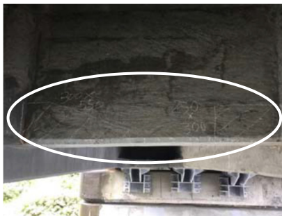
うき（未補修箇所）
