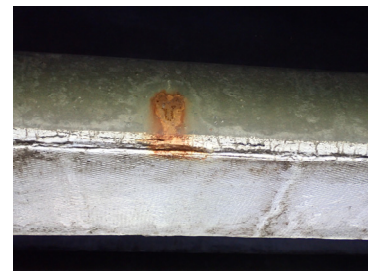
T桁ウェブ側面から錆汁
