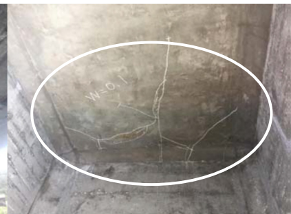
ひび割れ（未補修部）
