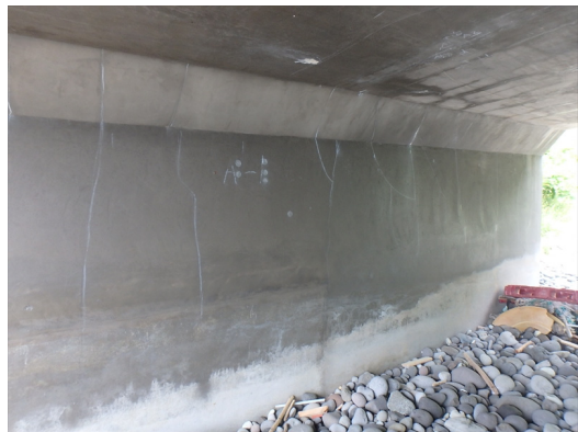
側壁：部分修復（犠牲陽極）、含浸材 未補修部でひび割れと遊離石灰
