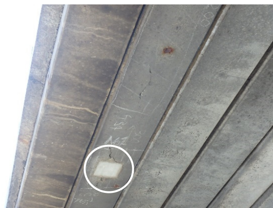
主桁再劣化箇所の H30 詳細調査跡
