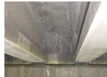
床版・横桁に遊離石灰
