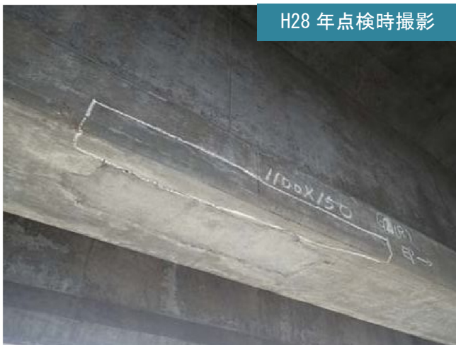
上部工：断面修復箇所のうき
