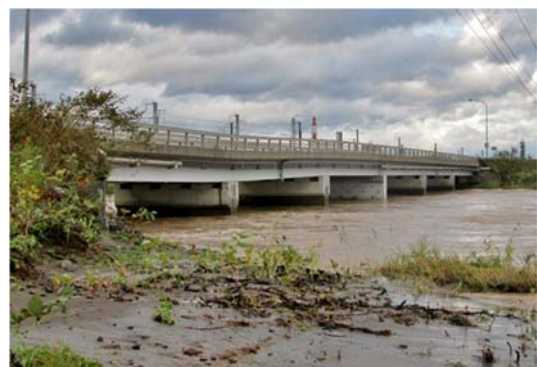
写真 9.2 国道 36 号竹浦橋被害状況
