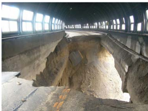
写真 9.1 国道 274 号日勝峠被害状況
