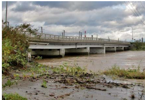
R36（竹浦橋の損傷）
