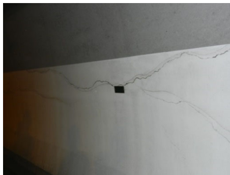
写真 6.4 春光台トンネル（下り線）ひび割れ状況
