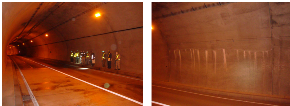
写真 6.8 キナウシトンネル視察状況（左）、ひび割れ状況（右）
