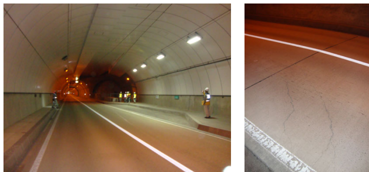
写真 6.9 大森トンネル分岐部状況（左）、路面隆起状況（右）
