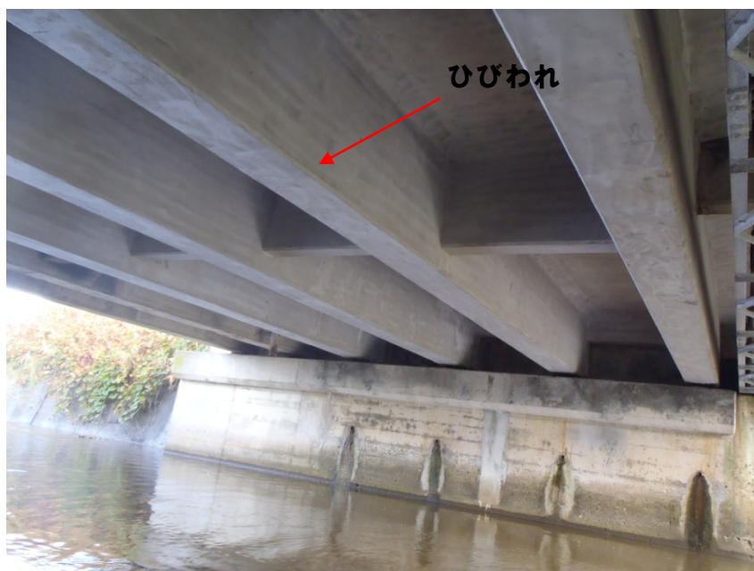
写真 5.7 臼谷橋の再劣化状況
