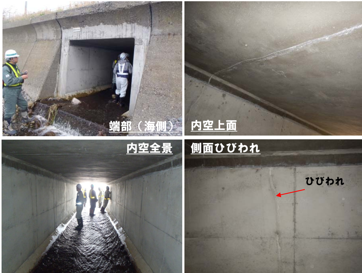
写真 5.8 萱泊橋(BOX)の再劣化状況
