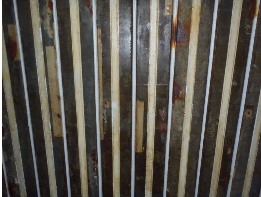
写真 5.6 礼受橋の再劣化状況
