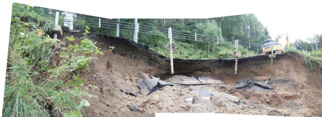
写真 4.13 被災箇所全景(2)
