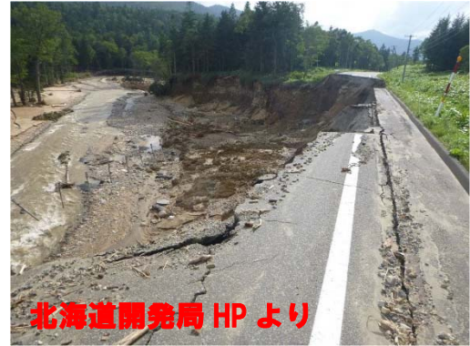
写真 4.2 現地被災状況（日高側を望む）
