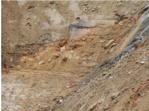
写真 4.3 崩壊断面状況
