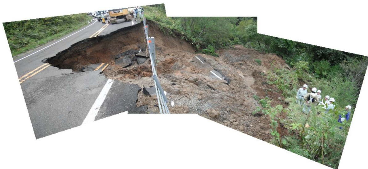
写真 4.12 被災箇所全景(1)
