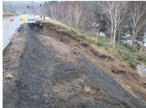
写真 4.7 現地被災状況(近景)
