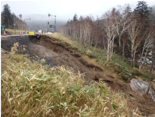
写真 4.6 現地被災状況(遠景)
