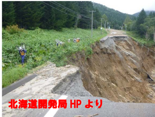
写真 4.1 崩壊断面状況（帯広側を望む）
