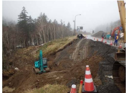
写真 4.9 被災箇所谷側の状況（日高側を望む）
