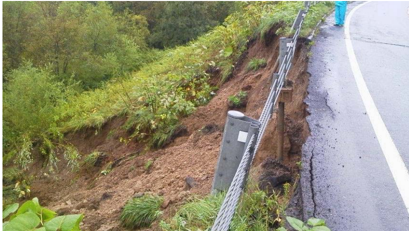
写真 4.14 平成 23 年 9 月 6 日 AM8:00 頃の状況（崩壊初期）
