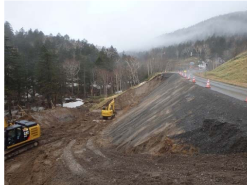
写真 4.4 現地被災状況
