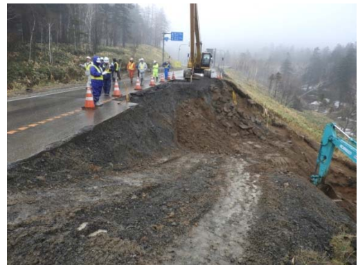
写真 4.11 被災箇所谷側の状況（帯広側を望む）
