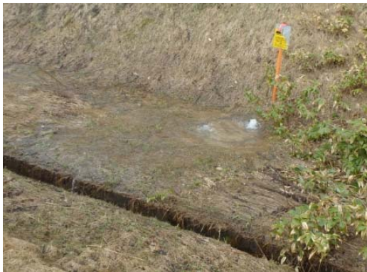
写真 4.5 現地箇所近傍のマンホールからの湧水
