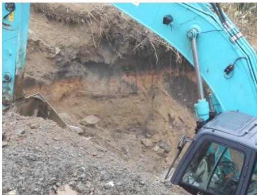
写真 4.10 被災箇所崩壊断面
