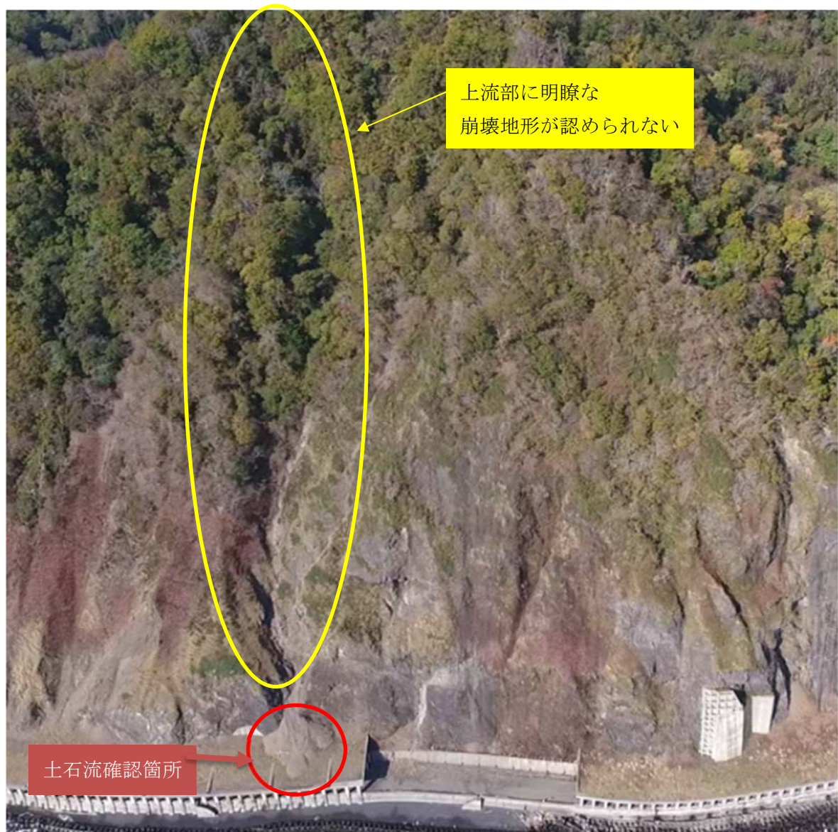
写真 3.5 土石流確認箇所の UAV による空中写真
