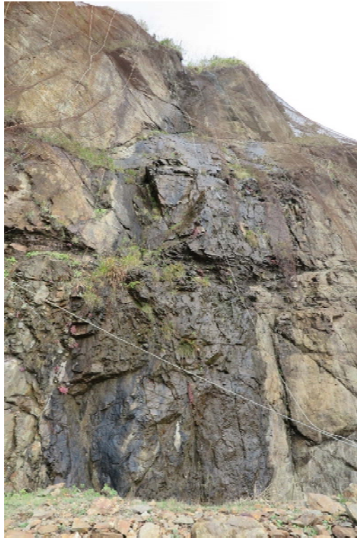
写真 3.3 写真 3.2 右側の岩盤崩壊箇所からの湧水
