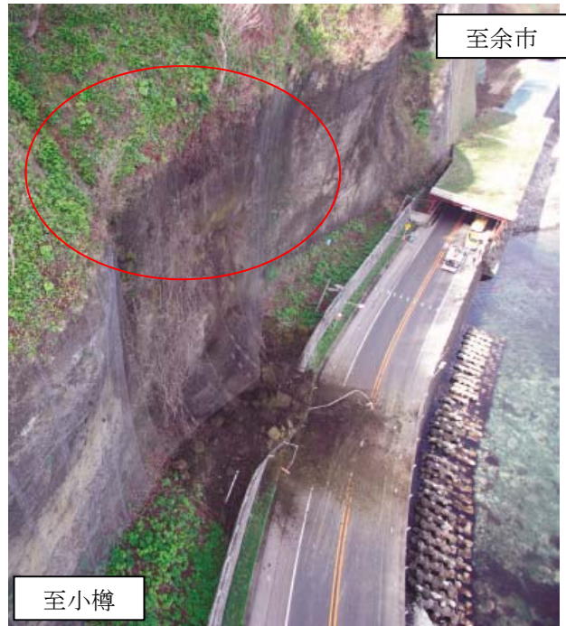
写真 3.7 平成 19 年の崩壊状況
