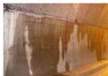
写真-水平打ち継ぎ目からの漏水（車道に達する場合は早期な措置が必要）
