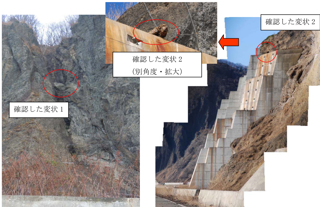
写真 3.2 現地部会で確認した変状
