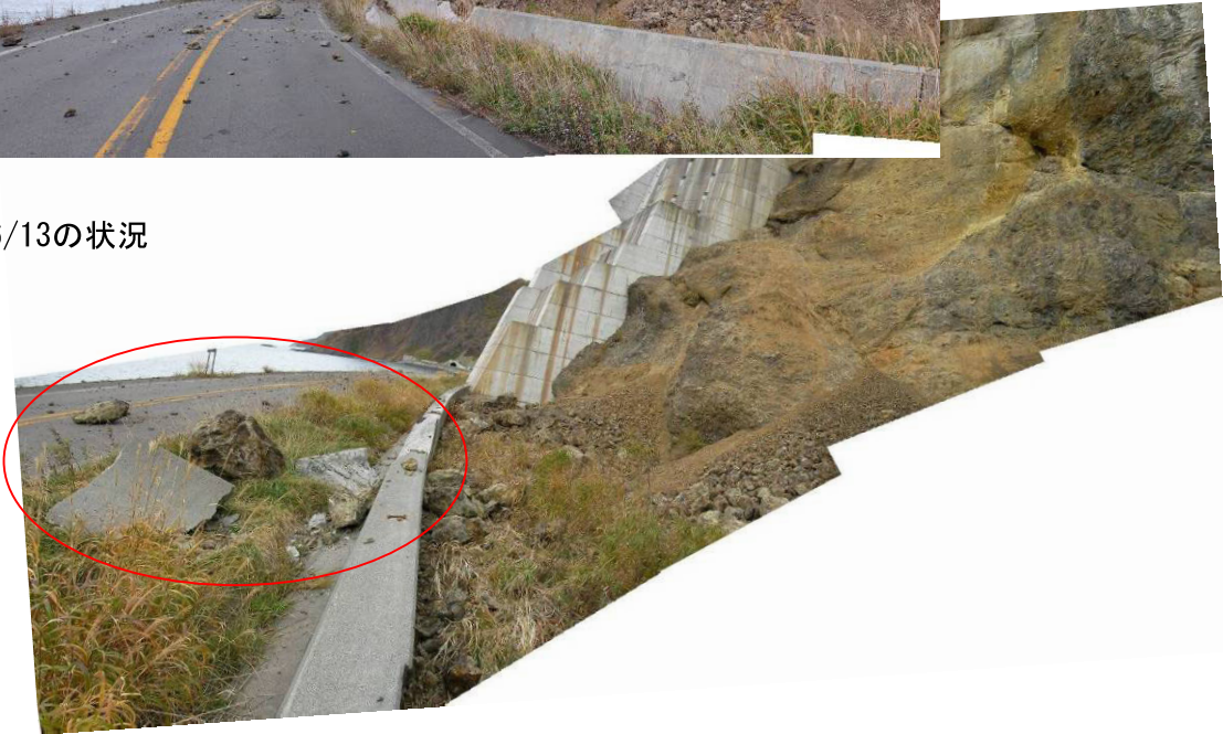
写真 3.6 擁壁の損壊状況
