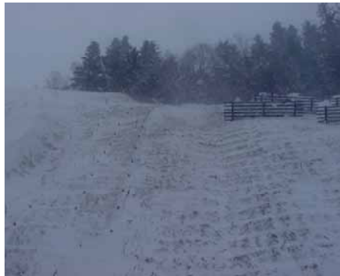
写真 9 - 13 雪崩発生直後の雪崩発生点付近の法面
