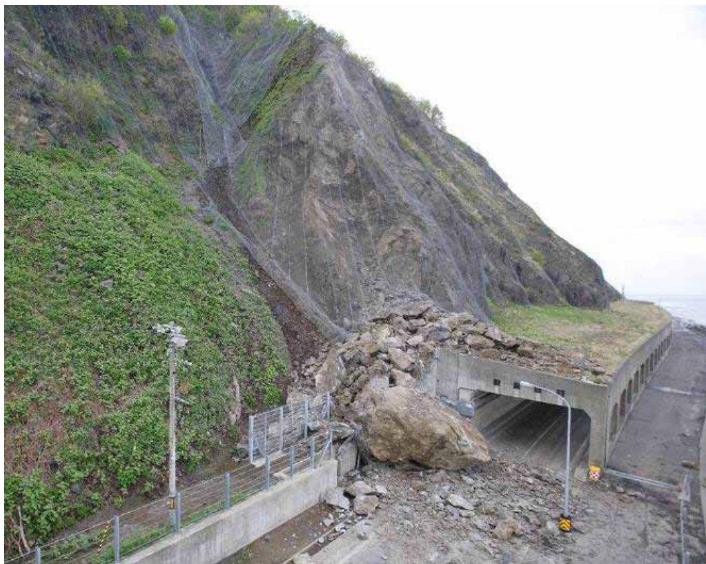
图 5-15 增毛町岩尾地区の岩盤崩落発生状況
