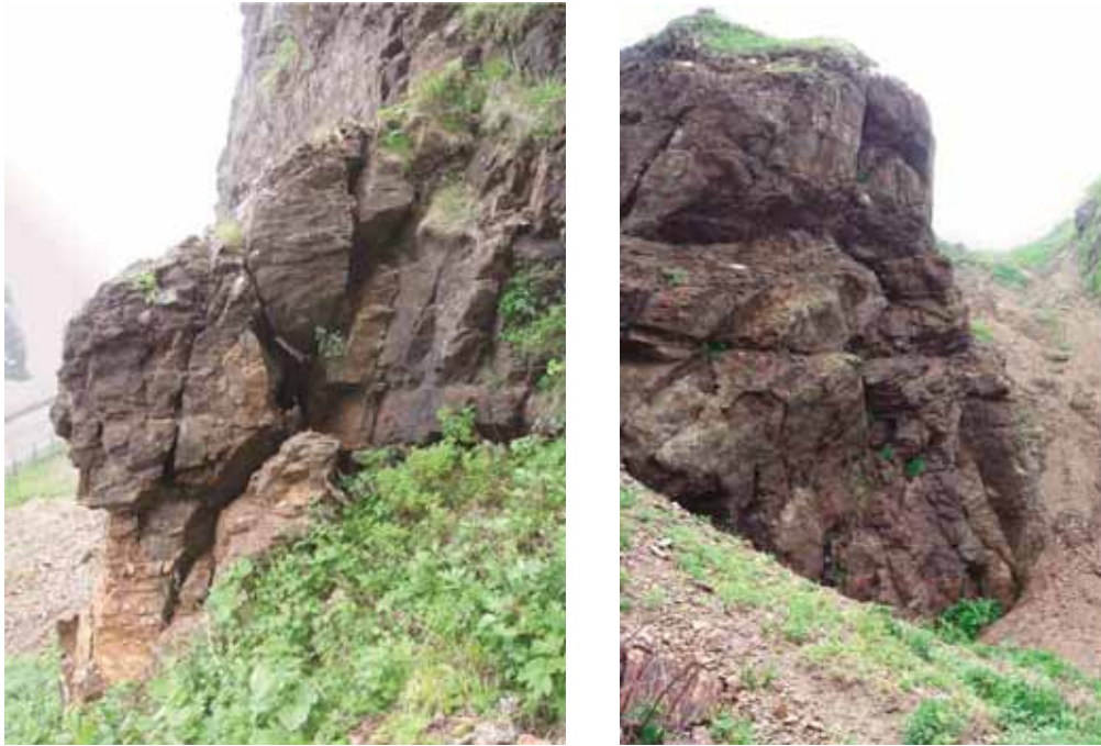
図 5－5 幌満地区亀裂の状況
