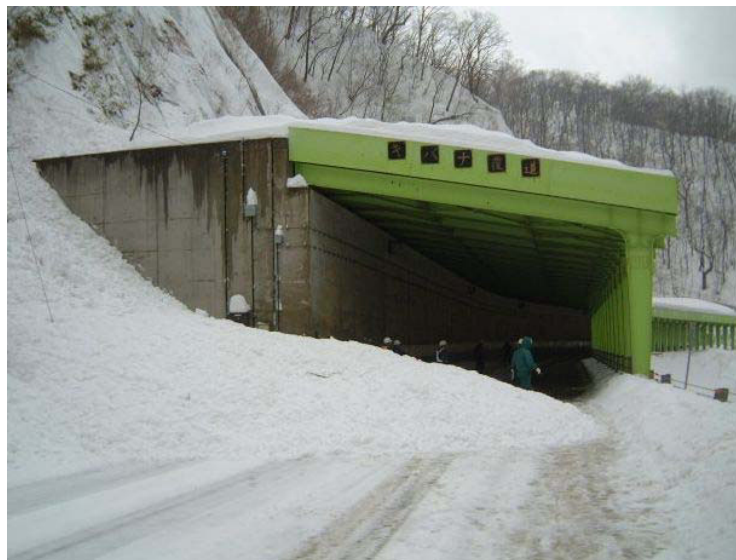
写真12-1 スノーシェッドをはみ出した雪崩のデブリ（堆雪）
