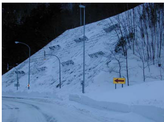
すべり面が整形のり面上であることから、雪崩は雪崩予防柵をすり抜けて崩落したことが推察できる（事例 No.23）
