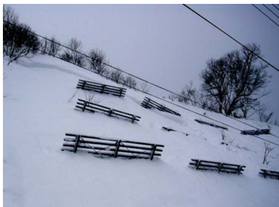
破断面が、斜面上部左端から雪崩予防柵を横切って斜め下方に走っているのが確認できる（事例 No.19）
