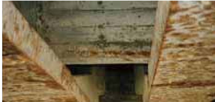
写真 9 - 1 １９９４年に発見された横桁の剥離・鉄筋露出
