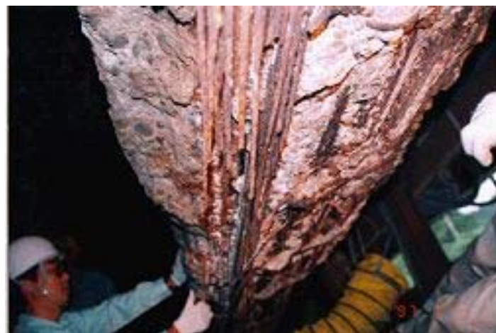
写真 9 - 3 １９９７年に発見された PC 鋼線の破断
