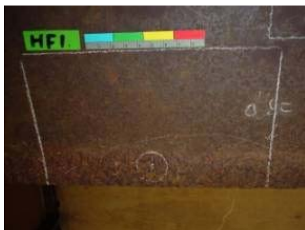
事例3 フランジ下面のこぶ状の錆
