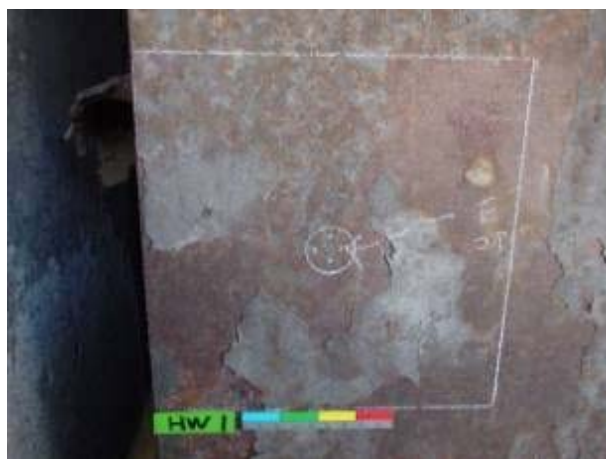
事例1 層状剥離の例
