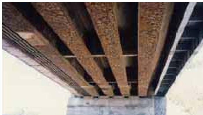
写真 9 - 2 １９９４年に発見された鋼板接着の損傷
