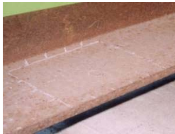
事例4 フランジ上面の層状剥離
