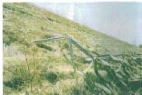
軽量法枠の浮き上がり被害
