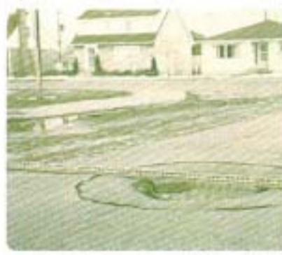
凍上によるマンホール周辺の被害
