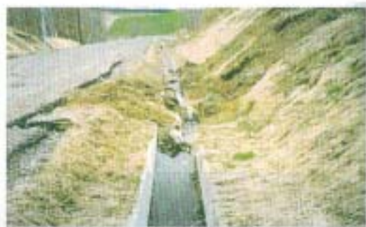
法面前壊とともに転倒破壊した道路側溝
