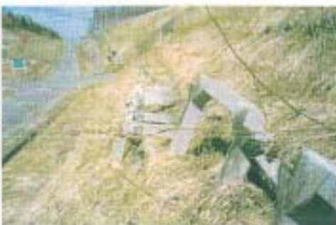
コンクリート法枠の浮き上がり被害
