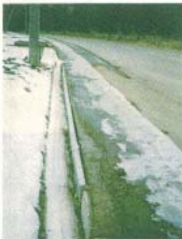
凍上による側溝の被害
