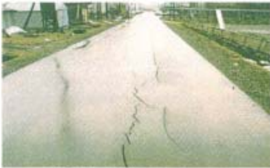
凍上による舗装のクラック
